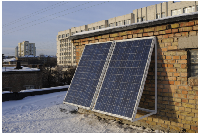
Рисунок 5 – Сонячні панелі на даху корпусу №17 НТУУ КП
